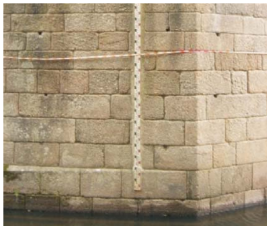
Fot. 7 - Escala hidrométrica de São Gonçalo.
