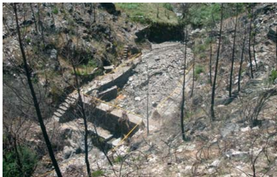
Fot. 18 - Aspecto da piscina fluvial do Soito da Ruiva, depois da enxurrada (22 de Junho de 2006).
