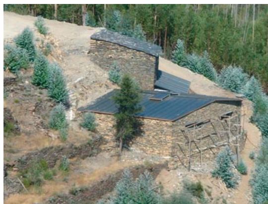
Fot. 10-A e B - Ovil do Torno. Em cima, em Maio de 2009, após ter sido destelhado por vendaval e, em baixo, em Setembro, depois da reposição da cobertura.
