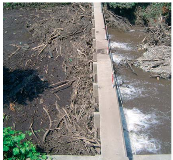
Fot. 22-A e B - Em cima, aspecto da remoção do material acumulado junto do pontão-açude da Vide (em 22 de Junho de 2006) e, em baixo, pormenor da acumulação de material, depois da segunda enxurrada (em 15 de Julho de 2006).
